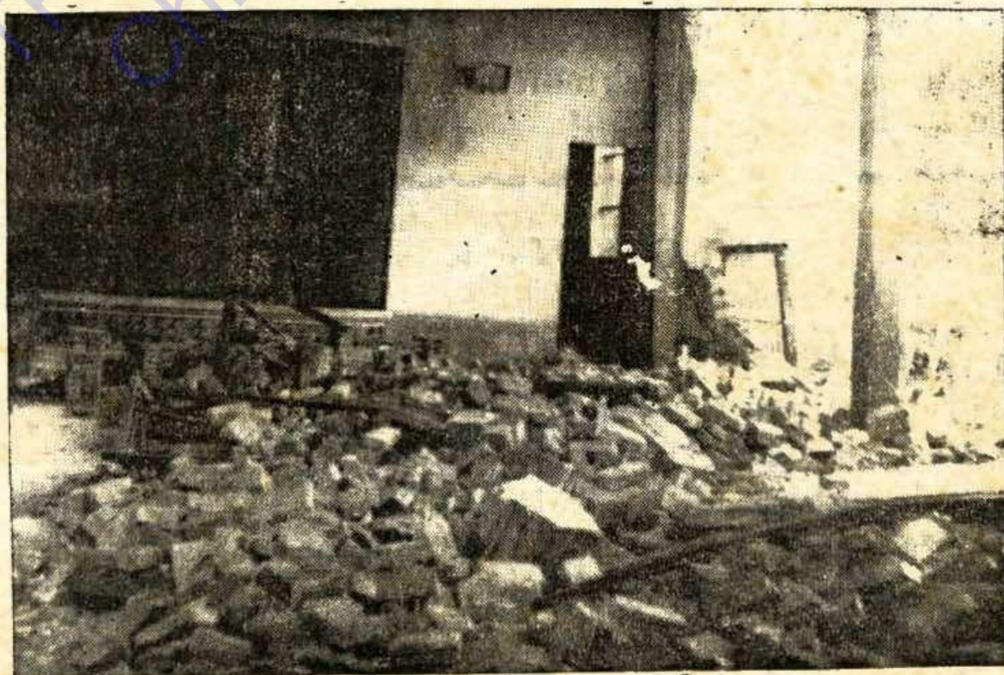
Hình nhà thờ của Hội-thánh Phong-thủ bị sụp đổ trong cơn bão tố ngày 18/9/64
